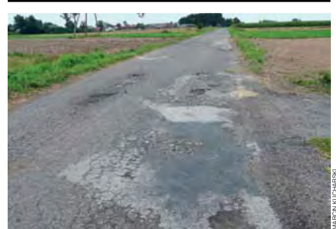
Stan drogi powiatowej pozostawia wiele do życzenia. Po ostatniej zimie
