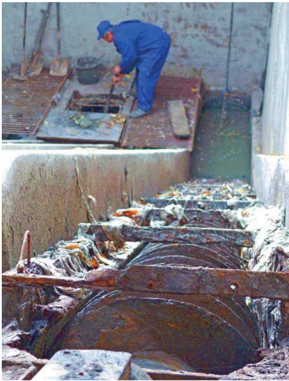
Pompa ślimakowa , która transportowała ścieki na wysokość 3 metrów, niedługo zniknie z przepompowni na Bratkowicach.
