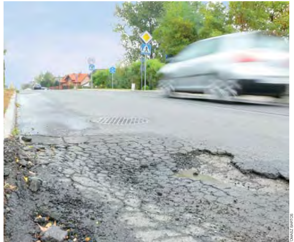
Za rozpadającą się nawierzchnią na ul. Kiernozkiej odpowiada znajdująca się tuż pod nią woda.
