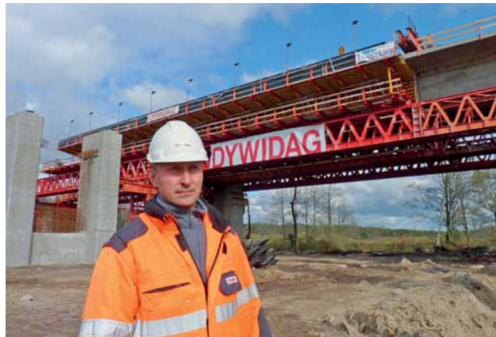
Tomasz Szymański, kierownik robót z ramienia Dywidagu. Ma pod sobą 200 ludzi, koordynuje prace tak, by wszystko, od dostaw, przez montaż, po sprzątanie, odbywało się zgodnie z liczącym 3,5 tysiąca pozycji harmonogramem.
