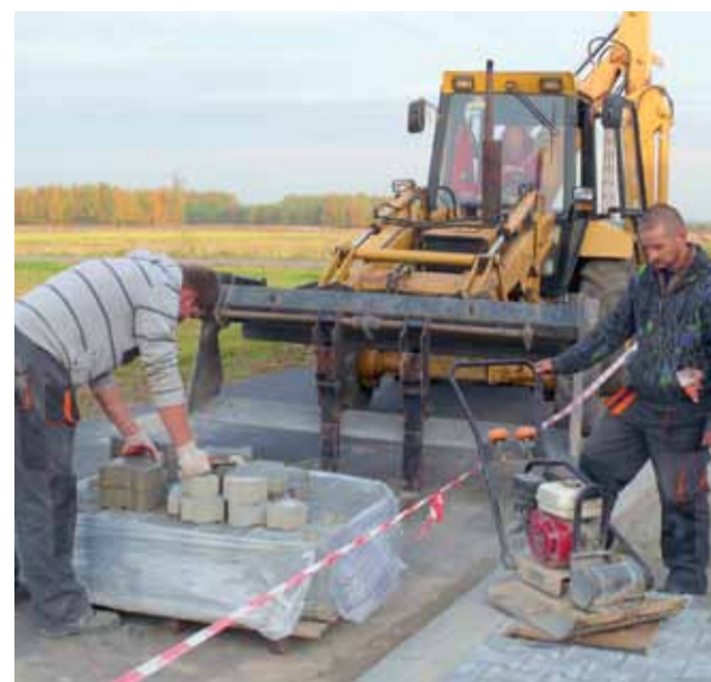
Przy strażnicy OSP w Mysłakowie kończy się budowa chodnika połączony z szerokim podjazdem do garaży.
