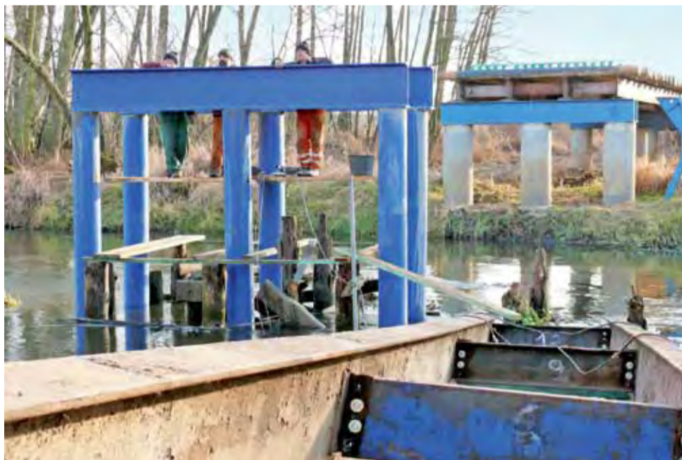
Tak wyglądał plac budowy w Patokach tydzień temu, dziś na położonych na podporze tregach montowana jest drewniana nawierzchnia.
