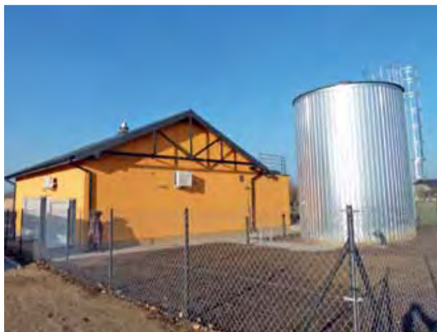
Nowoczesna hydrofornia w Wyborowie. Wydajność studni dostarczającej wodę wynosi 43 m 3 w ciągu godziny.
