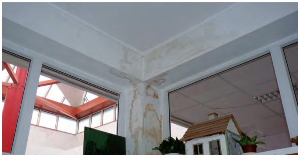
Plamy na suficie i ścianach. Zacieki z przeciekającej z dachu wody szpecą szkolne pracownie i korytarze.
