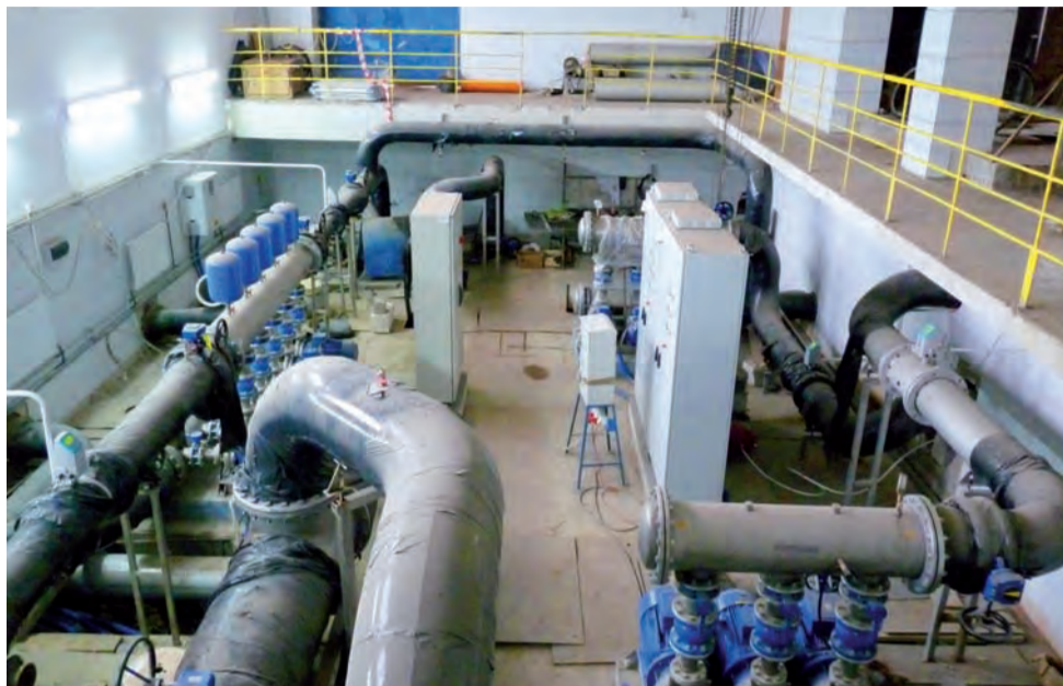
System pomp na modernizowanym ujęciu wody na Blichu. Cała inwestycja kosztuje ok. 20 mln złotych, ale ZUK wskazuje potrzebę wielu innych modernizacji, a do tego potrzebne są pieniądze, stąd podwyżki cen za wodę i ścieki.
