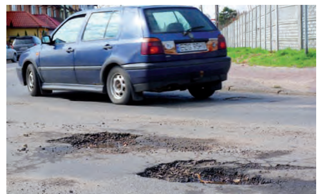
Dziura na dziurze w rejonie skrzyżowania ul. Kopernika z ul. Solskiego
