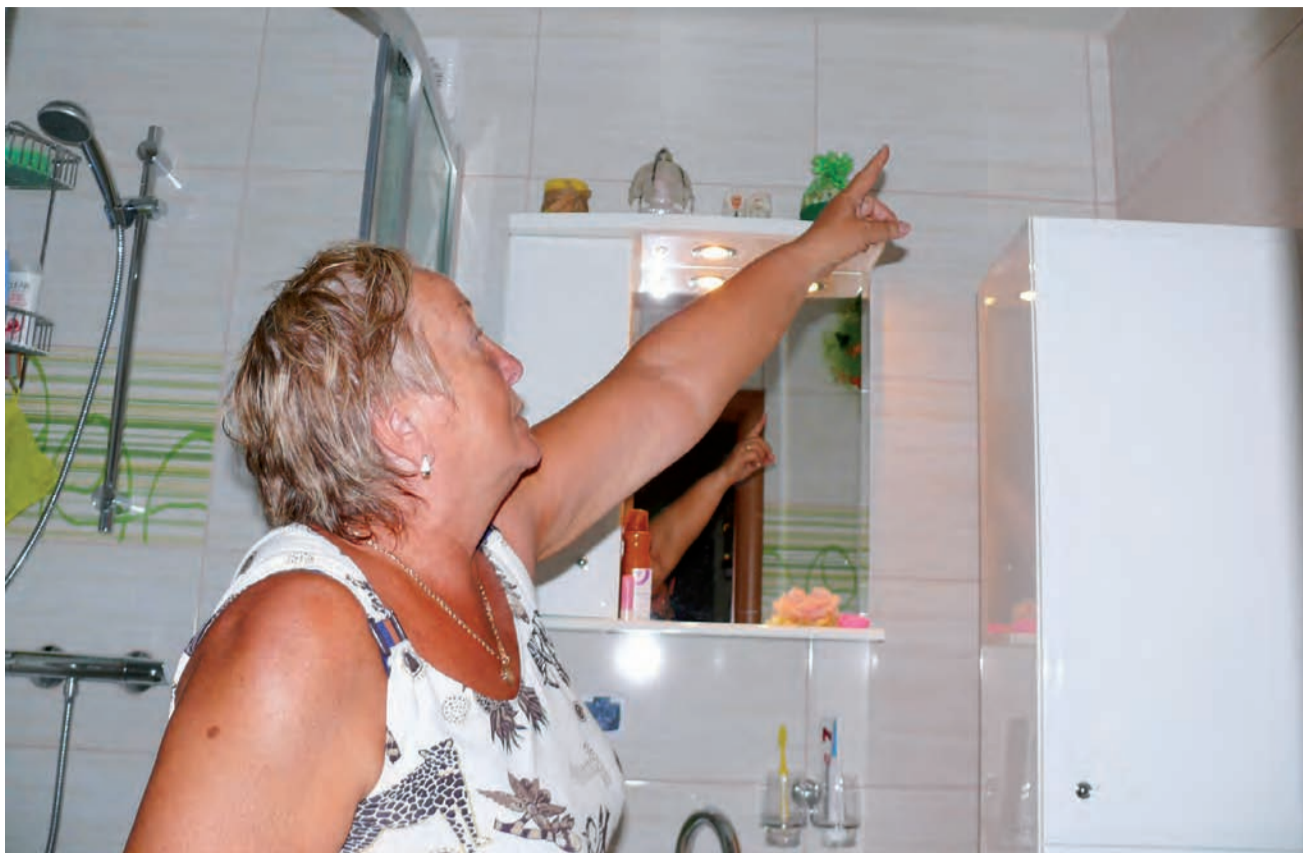
Pani Bogusława pokazuje, w których miejscach woda kapłała z sufitu.
