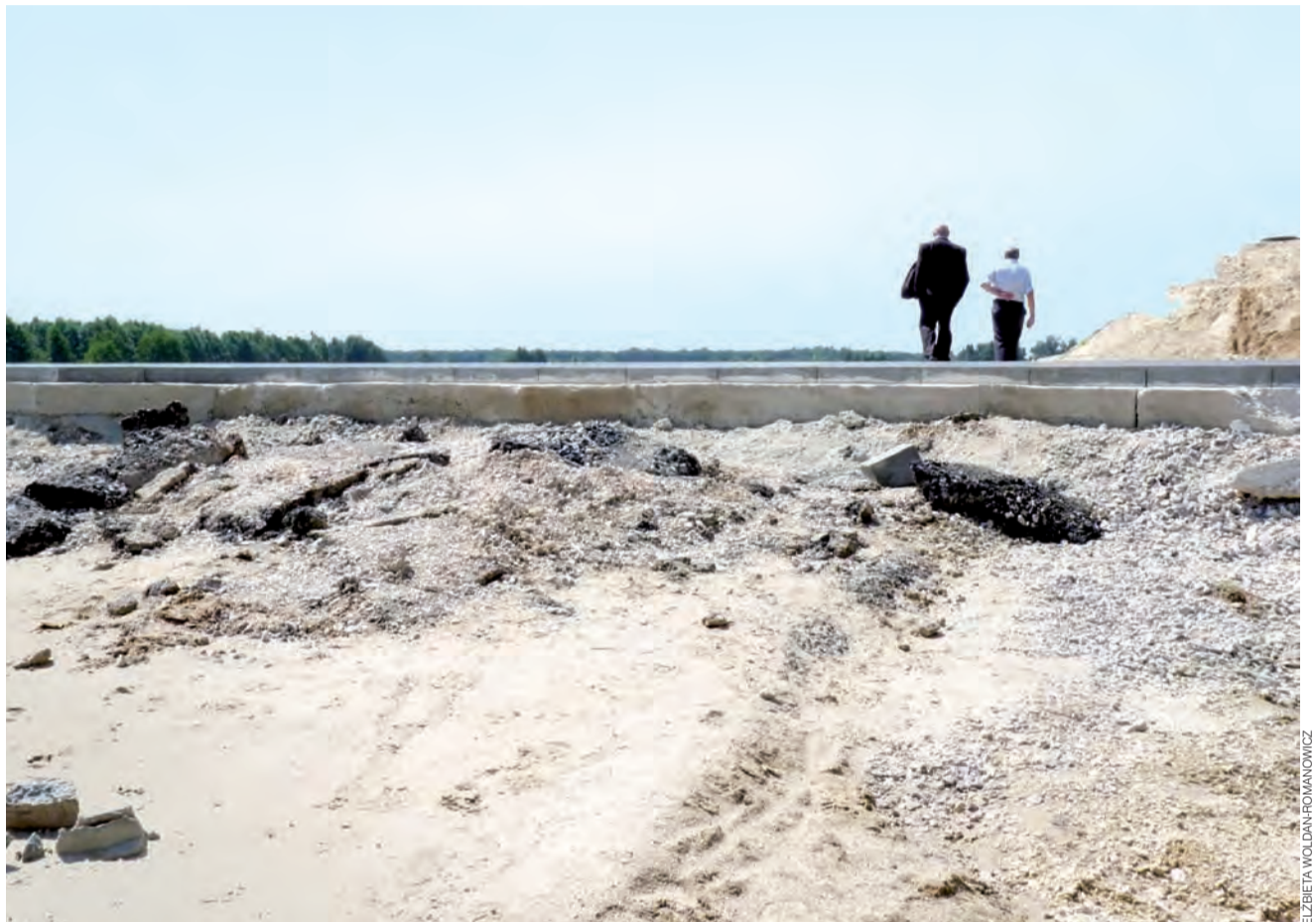
Budowa A-1. Jeszcze do niedawna rolnicy mogli tędy przejechać do swoich pól po drugiej stronie budowy. Teraz uniemożliwia to wysoki krawężnik, a wykonawca powinien wyznaczyć nowy dojazd.
