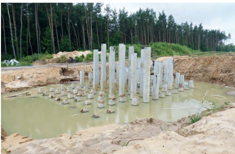
Zalana wodą konstrukcja żelbetowa mostu na Mrodze pod Dmosinem bez osuszenia nie nadaje się do kontynuacji robót.
