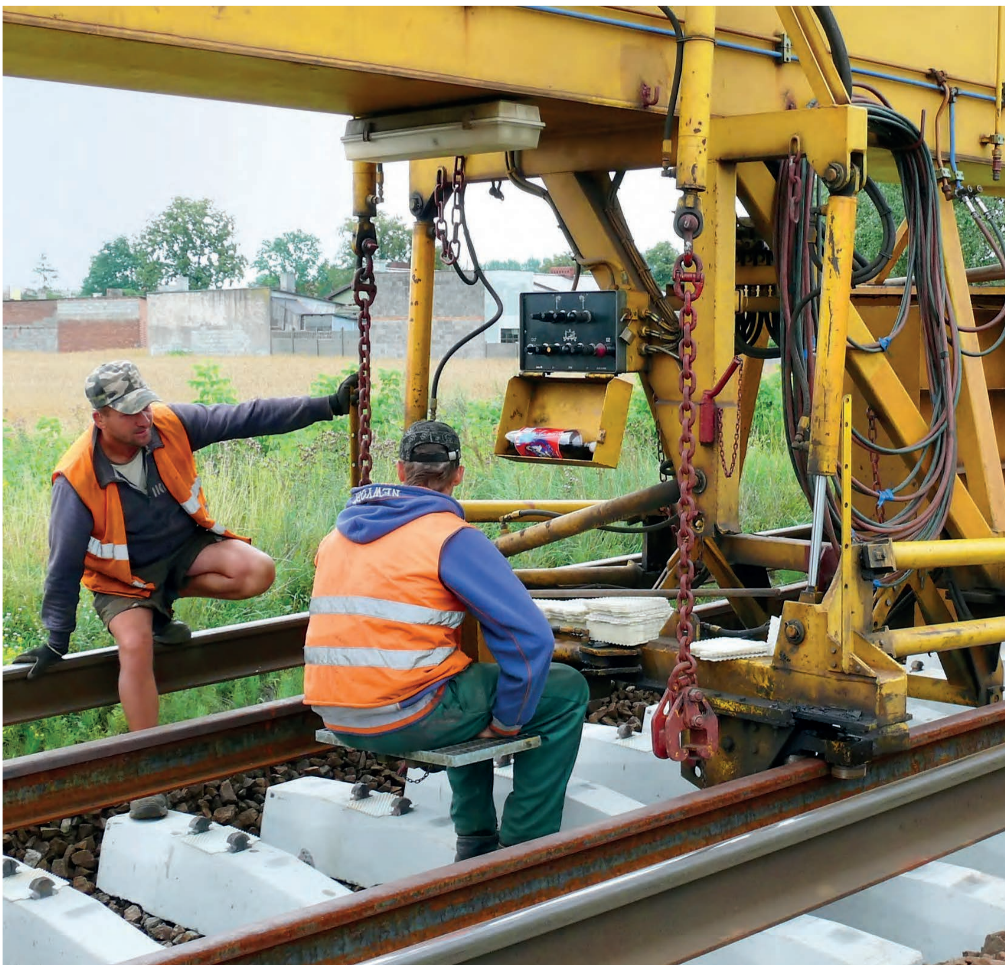
Maszyna PUN-2 układa betonowe podkłady, a na nich tory. Pracownicy Przedsiębiorstwa Napraw Infrastruktury kontrolują proces na każdym etapie.
