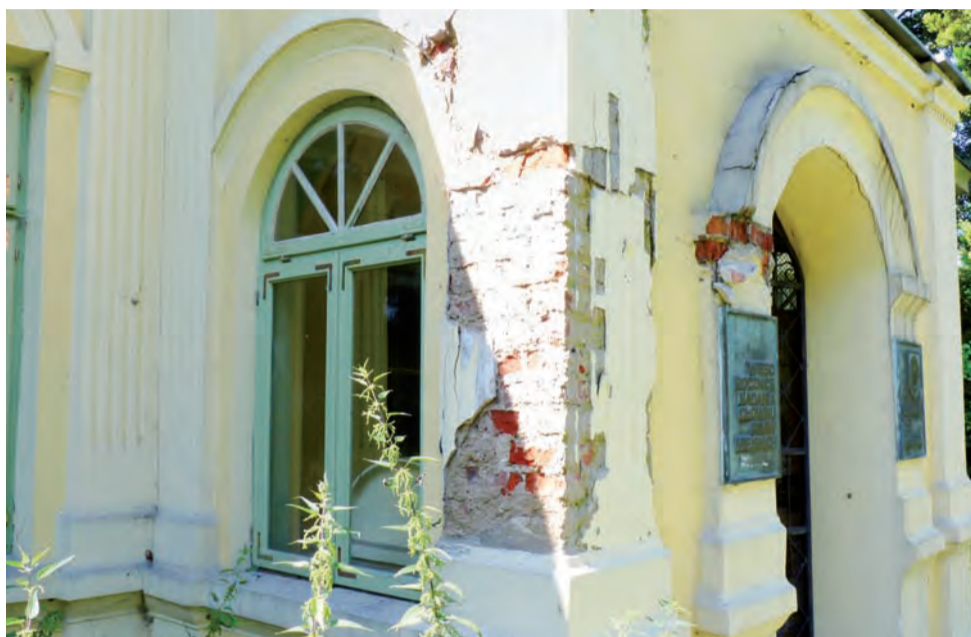
Patrząc na te odpadające połacie tynku aż trudno uwierzyć, że elewacja ta przeszła gruntowny lifting niespełna trzy lata temu.
