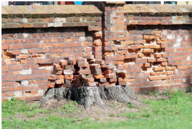
Na pierwszym planie cegły z rozebranego słupka. W tle ogrodzenie, które też wymaga remontu.
