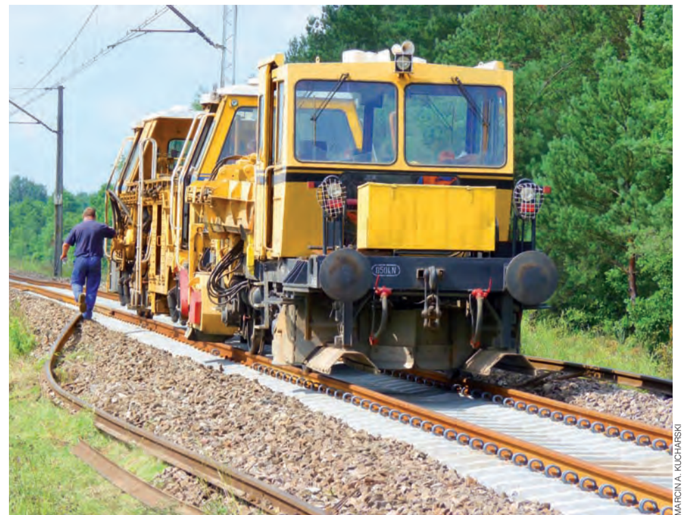
Po remontowanych torach kilkakrotnie przejeżdżały specjalistyczne pociągi techniczne. Jedne wymieniały podkłady i szyny, inne prostowały i „podbijały” tor.
