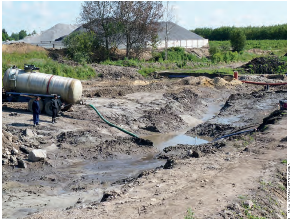
Okolice ulic Stodolnianej i Zakładowej w Strykowie. Budownicy obwodnicy właśnie tutaj borykają się od wielu dni z kłopotami, jakie powoduje podsiąkająca woda.
