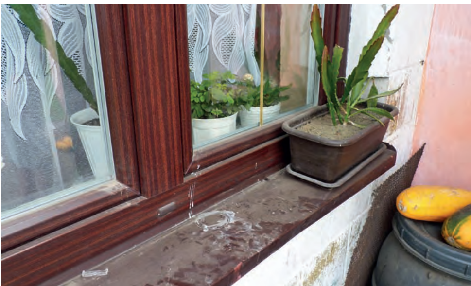
Pył jest wszędzie. Osiada na dachach, oknach, parapetach, drzewach, trawie, samochodach. Szczelinami wciśka się do wnętrza domów, stodół i pomieszczeń gospodarczych.
