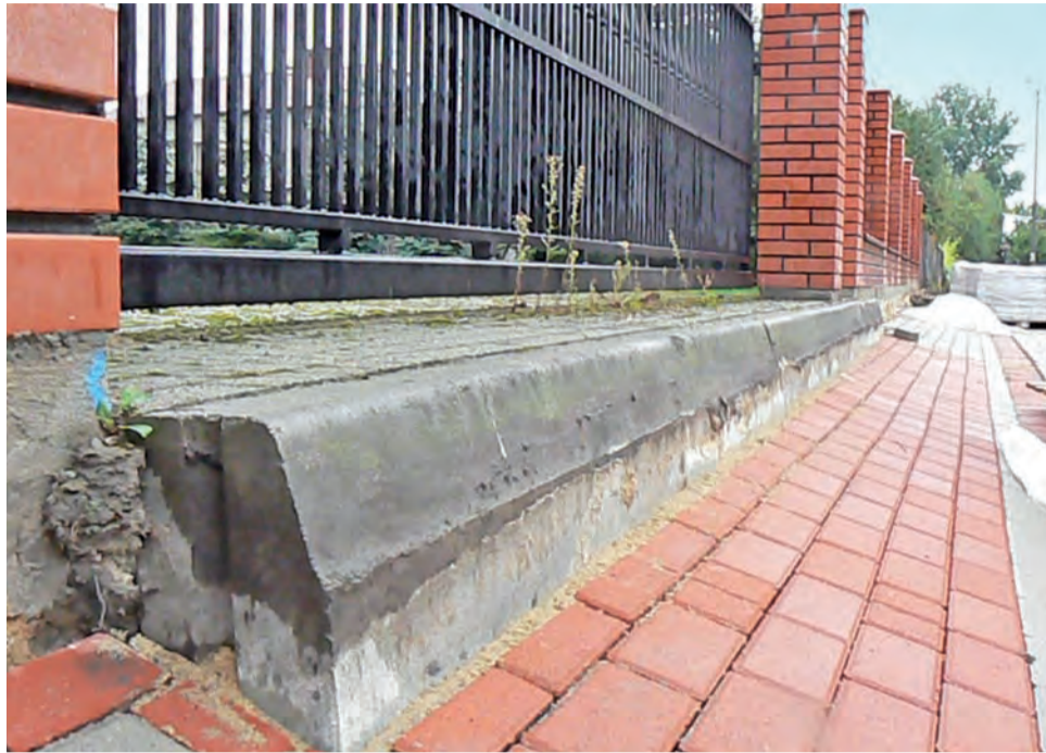
Po remoncie nawierzchni na ul. Ogrodowej wyjazd z posesji państwa Sierotów tylną bramą jest niemożliwy.
