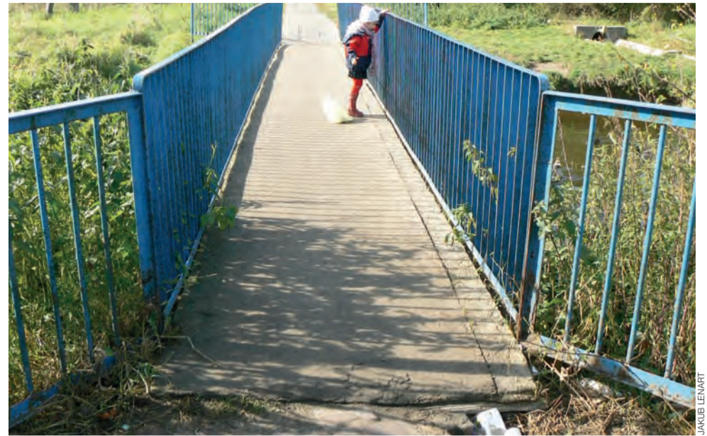
To właśnie przez ten mostek skracają sobie drogę mieszkańcy dwóch głowieńskich osiedli. Na dole widoczny ubytek w stanie kostki brukowej.
