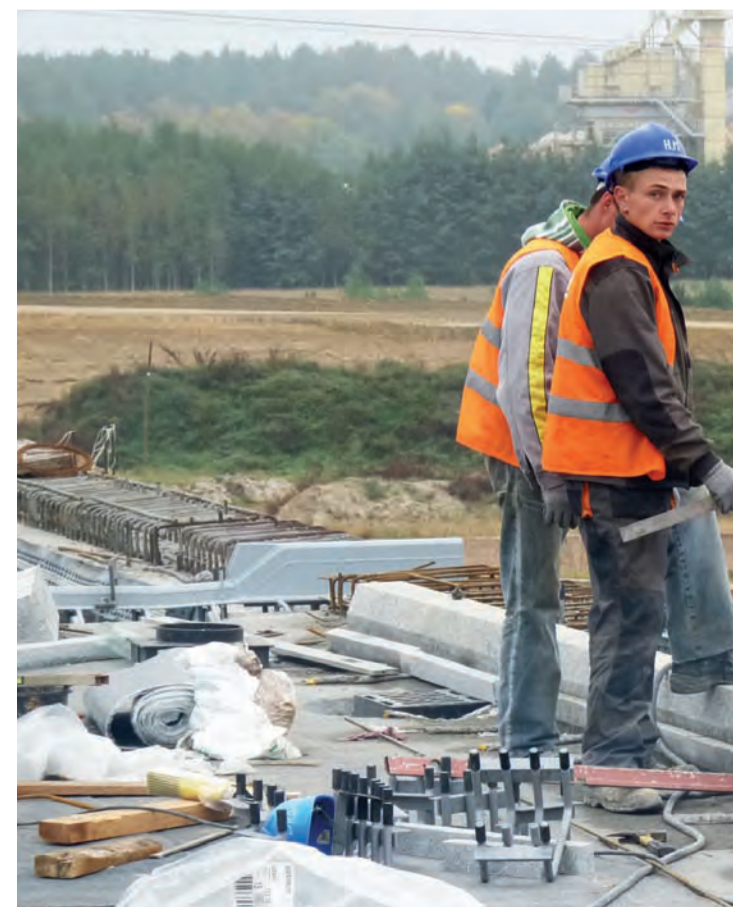
Na budowie autostrady pracuje też wielu młodych ludzi. Na zdjęciu pracownicy przy budowie estakady węzła „Skierniewice” w okolicach Nieborowa, na skrzyżowaniu drogi Łowicz-Skierniewice.
