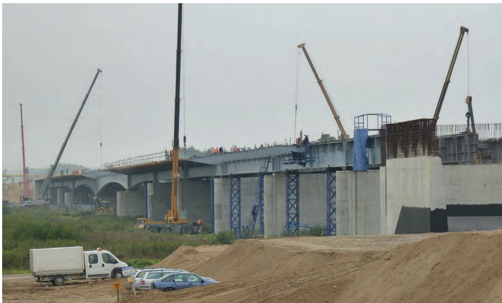
Most nad Rawką, tutaj sfotografowany od strony Woli Szydłowieckiej, jest imponującą budowlą. Przy jego budowie pracują ciągle kilka dźwigów.
