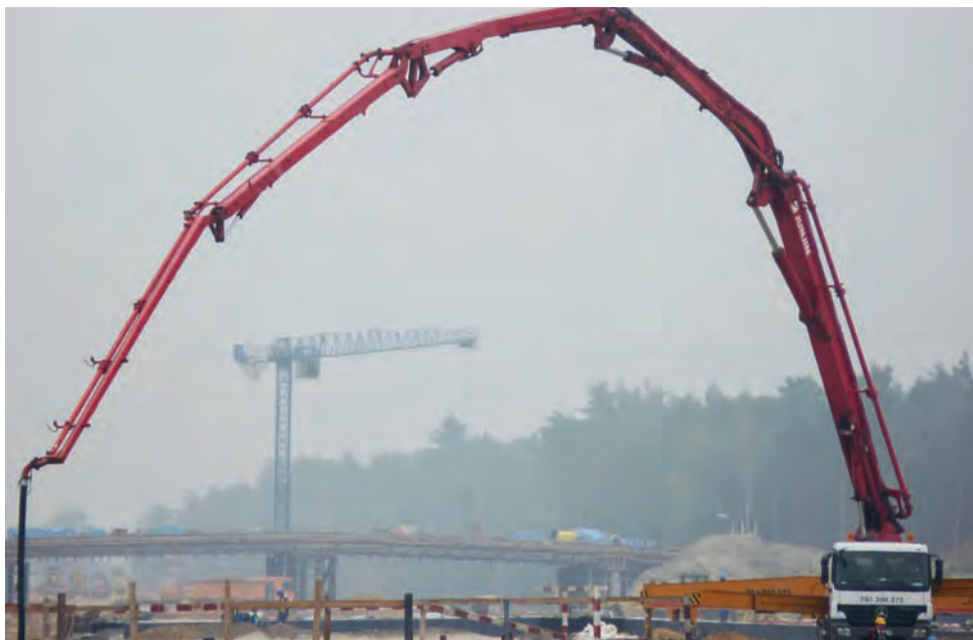
Niektóre widoki na autostradzie, tak jak ten uwieczniony w połowie odcinka budowy moment wylewania betonu, są bardzo malownicze.
