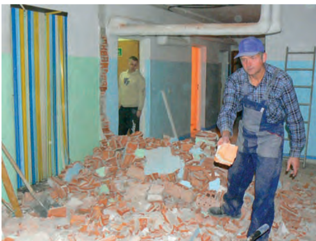
Piwniczne pomieszczenia rehabilitacji na razie wyglądają jak wielkie gruzowisko.
