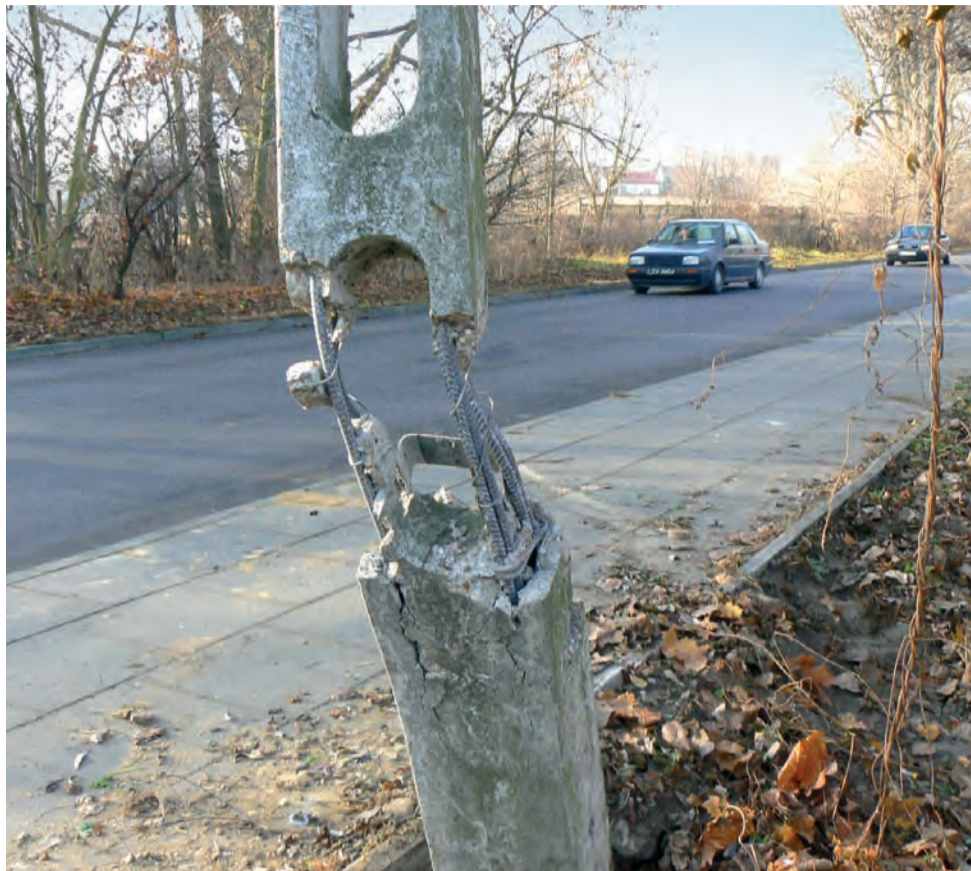
Zniszczony słup przy ul. Solskiego w Głownie.
