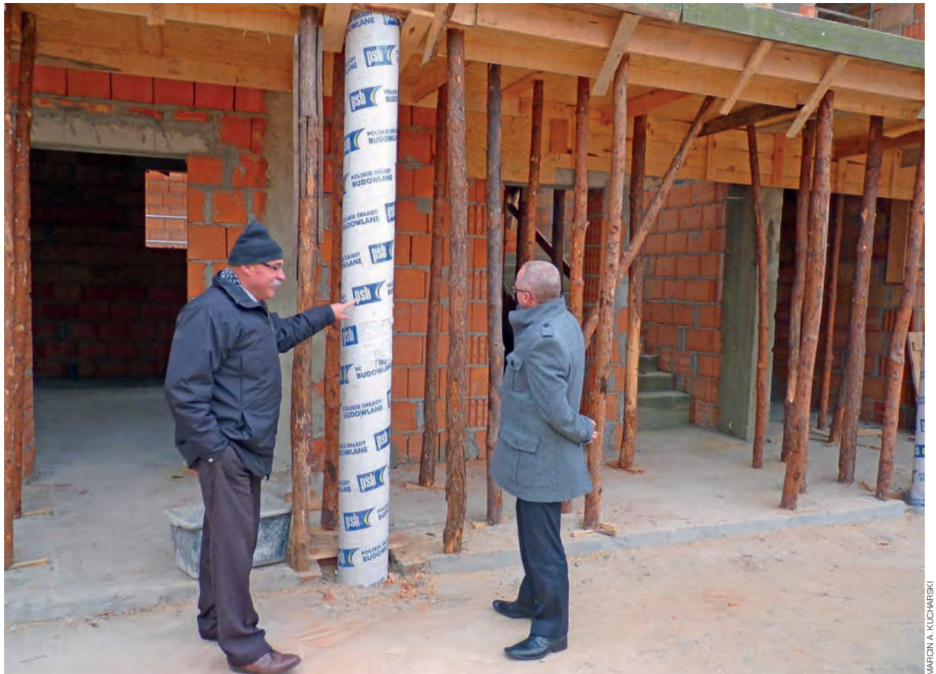
Sala gimnastyczna w Popowie Głowieńskim ma mieć antresolę, z której będzie można np. oglądać zawody. Konstrukcję antresoli oglądają wójt gminy Głowno Marek Józwiak i dyrektor zespołu szkół Krzysztof Fortuna.
