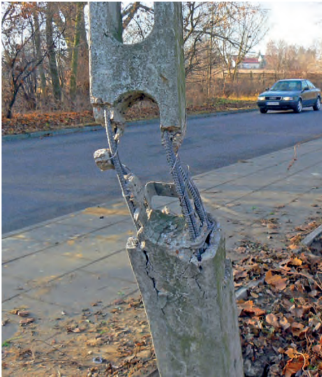
Uszkodzony słup przy ul. Solskiego w Głownie.
