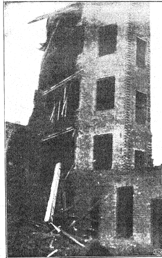
Przy ul. Zeromskiego na terenie poczty Nr. 65, rozsypał się gruz nowowznoszony dom trzechpiętrowy. Powyżej ruiny budowli.
