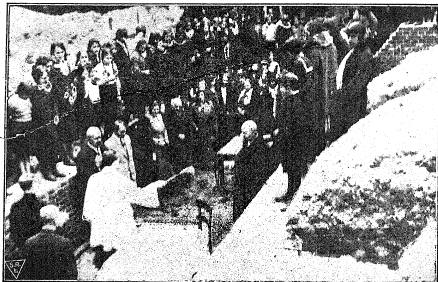
Osiedle państwowe gimnazjum żeńskiego im. Em. Szczanieckiej w Sokolnikach. Moment poświęcenia fundamentów pod budowę pierwszego pawilonu.
