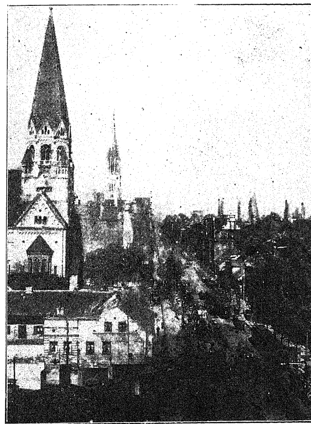
Kanalizowanie Łodzi odbywa się w szybkim tempie. Przy zbiegu ul. Piotrkowskiej i Czerwonej wybudowany został ostatecznie olbrzymi kanał dzwonowy. Na zdjęciu widzimy rusztowanie przy budowie. Woddali kościół katedralny oraz ul. Piotrkowska w perspektywie.
