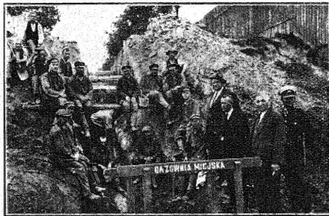
Roboty ziemne gazowni Miejskiej w Łodzi. Rewizja rur 14-calowych i przekładanie 8-calowych przy ul. Srebrzyńskiej.
