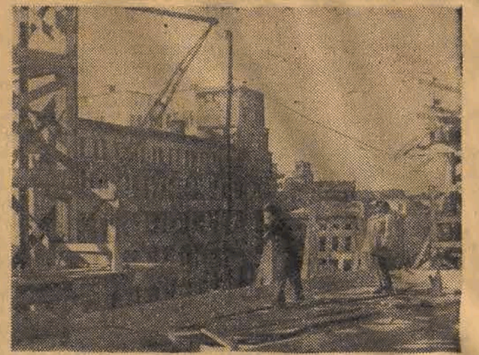
Prace przy budowie Centralnego Domu PZPR w Stolicy szybko posuwają się naprzód. O statnio zatrudnieni przy robotach pracownicy, kierownik Henryk Krótkopat i majster Andrzej Łaziński, skonstruowali własnego pomysłu windę pomocniczą przy dźwigach, która daje duże oszczędności na transporcie i przyspiesza wydat nie tok robót.
