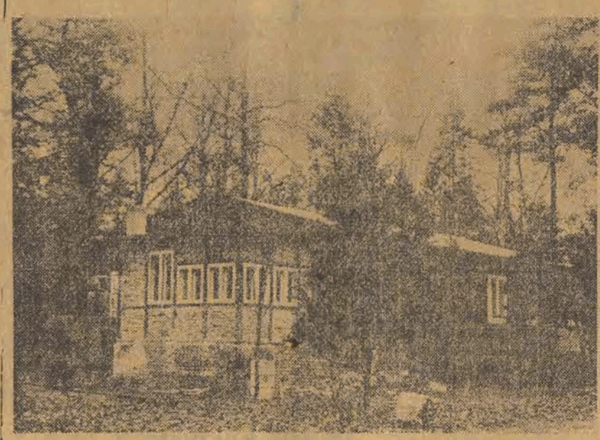
Jeden z 16-tych malarzanych domów willewanych, remontowanych w Arturówku dla studentów łódzkiej wyższej uczelni. Remont jest już na ukończeniu i jeszcze w tym roku domy będą oddane do użytku.
