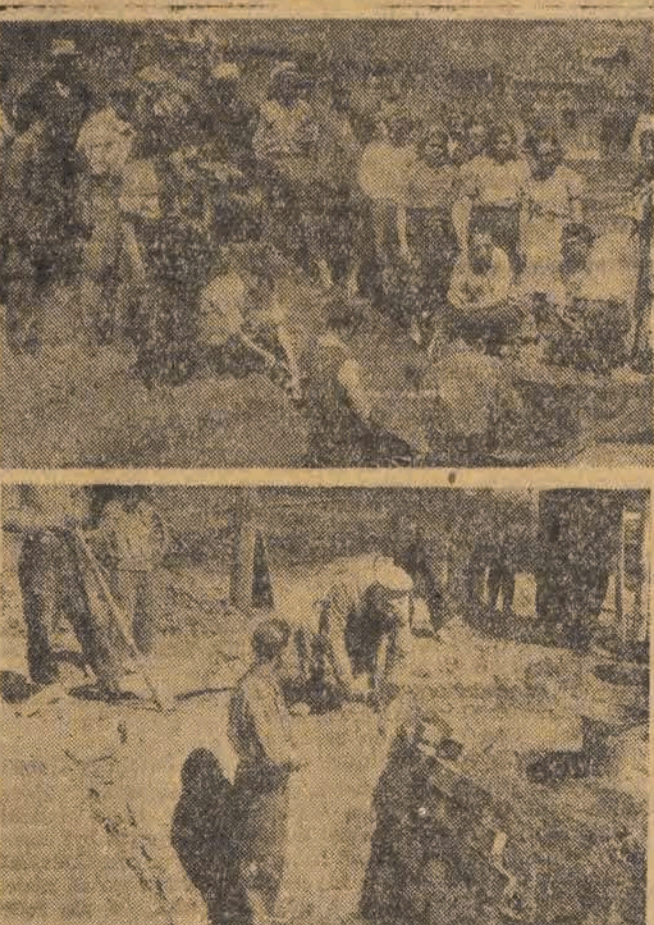
W ośrodku Oświaty Rolniczej w Psukokociach chłopowie z młodzieżą zakładają silosy. U góry wykładanie silosu papą, u dołu budowa silosu z cegły.
