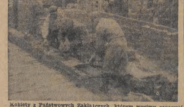
Kobiety z Państwowych Zakładów Przemysłu Dzierwiarskiego im. Ofiar 10 września czekają z niecierpliwością na budujący się obecnie żłobek dla dzieci. Czekają już dosyć długo — miał być gotowy latem roku bież., ale przy wykopach natrafiono na wodę, którą trzeba było wypompować. Ta nieprzewidziana przeszkoda opóźniła budowę. Obecny plan prac przewiduje jej ukończenie na 15 listopada br.
