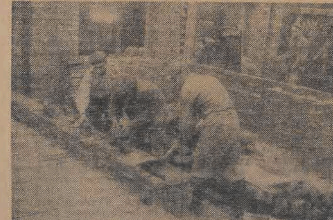
Kobiety z Państwowych Zakładów Przemysłu Dziewiarskiego im. Ofiar 10 września czekają z niecierpliwością na budujący się obecnie żłobek dla dzieci. Czekają już dosyć długo — miał być gotowy latem roku bieżącego, ale przy wykopach natrafiono na wodę, którą trzeba było wypompować. Ta nieprzewidziana przez szkoda opóźniła budowę. Obecny plan prac przewiduje jej ukończenie na 15 listopada br.
