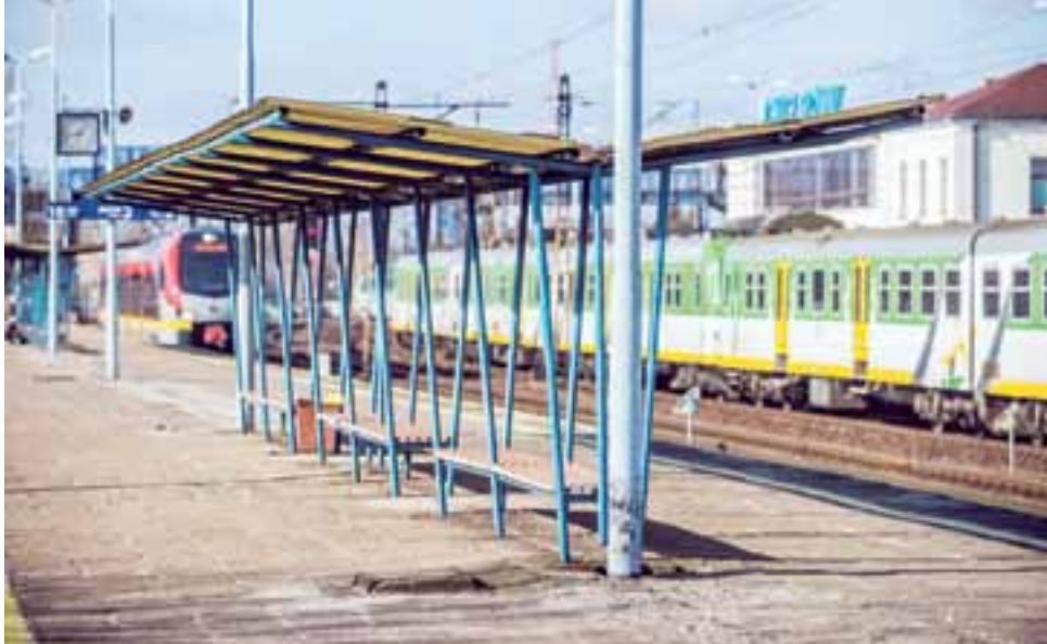
Stare wiaty, stara nawierzchnia peronów. Na porządy remont stacja czekała wiele lat.
