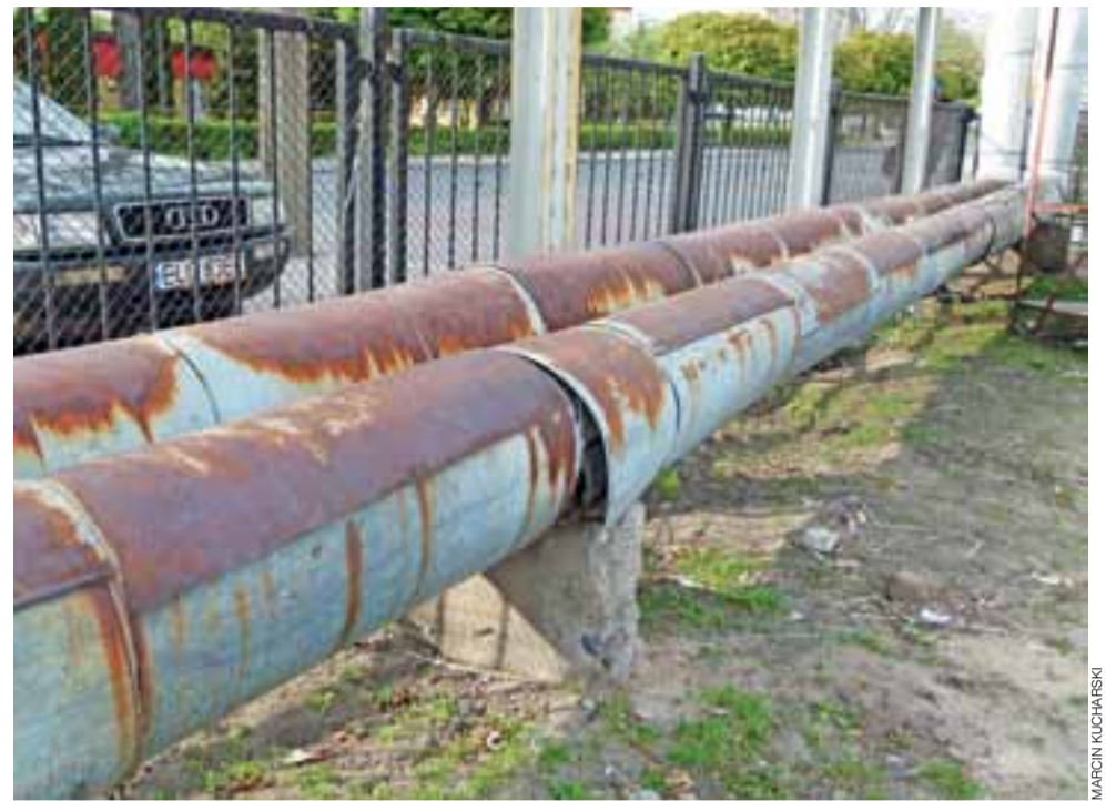
Naziemny ciepłociąg jeszcze w tym roku zniknie z targowiska miejskiego.
