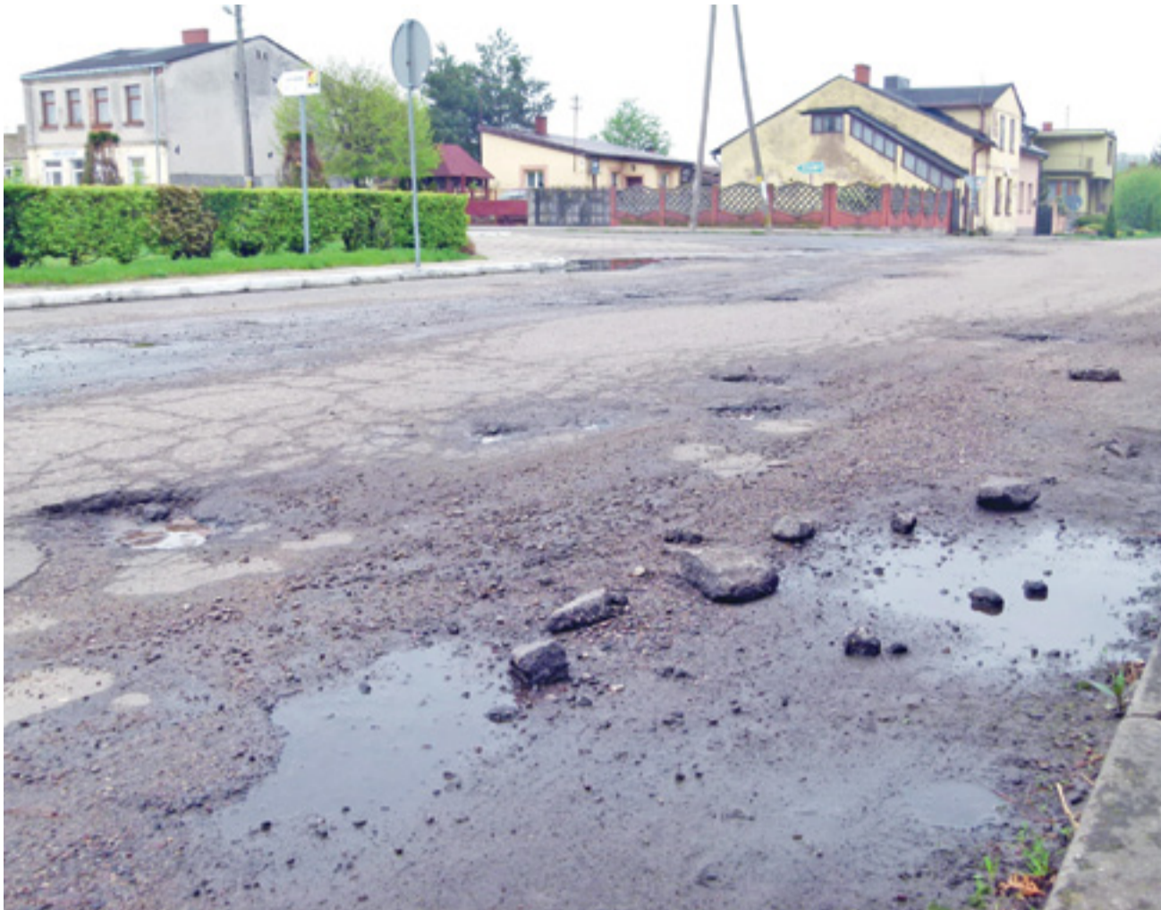
Pokruszony asfalt i dziury. Tak wygląda nawierzchnia jezdni powiatówki w centrum Soboty, stan na 8 maja.
