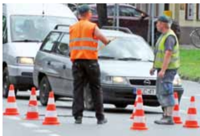
Malowanie pasów na drogach poprzedzone jest wytyczeniem wg planu. Na zdjęciu roboty na Końskim Targu prowadzone 12 czerwca.
