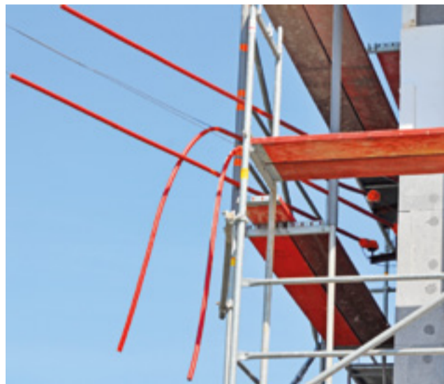
Czy takie zabezpieczenie przewodów pod napięciem było właściwe będzie oceniła prokuratura oraz inspekcja pracy.
