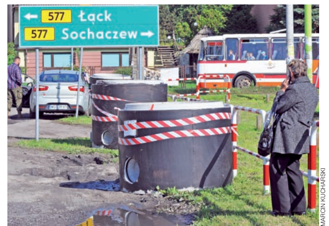
Gmina będzie mogła „podpiąć się” z kolektorem, którym będą odprowadzane wody deszczowe z terenu się w sąsiedztwie szkoły.
