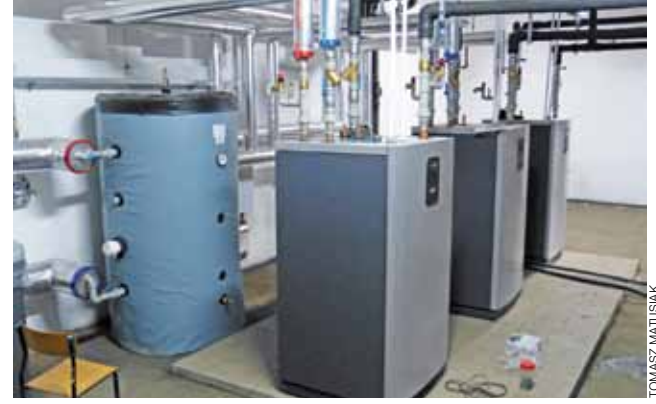
Pieco po termomodernizacji – na razie uruchomiono jeden, co przy tej temperaturze na zewnątrz powinno wystarczać do utrzymania w szkole odpowiedniego poziomu ciepła.
