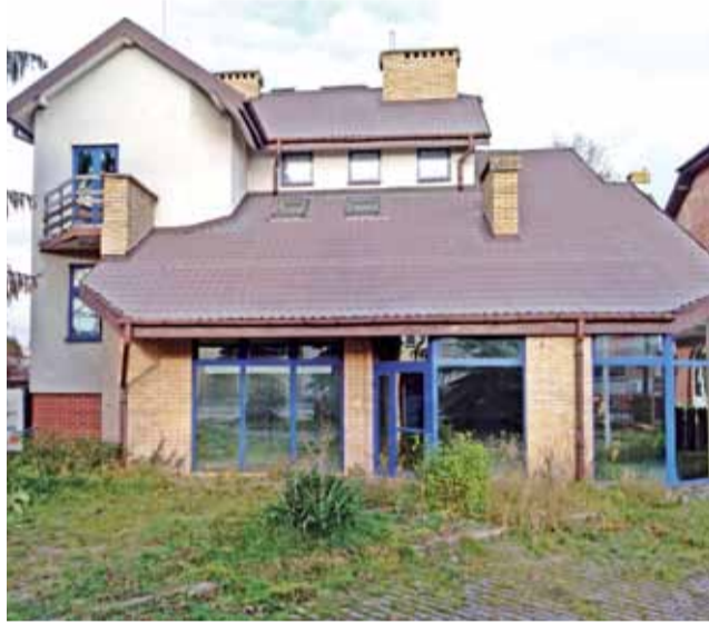
Budynek przy ul. Warszawskiej w Sannikach oraz jego najbliższe otoczenie są w coraz gorszym stanie.
