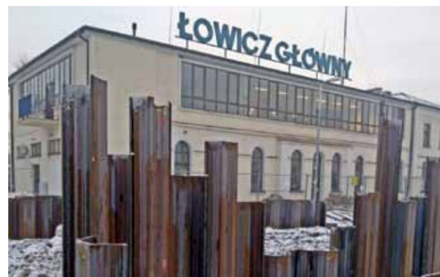
Trwające przy dworcu remonty mogą być jeszcze niejedną przyczyną przerwy w dostawie energii elektrycznej do budynku dworca.
