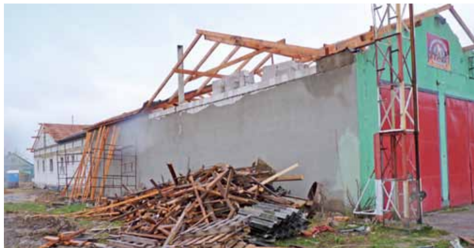
Za pół roku w tym miejscu mieszkańcy będą cieszyć się świetlicą w zupełnie nowym wydaniu.
