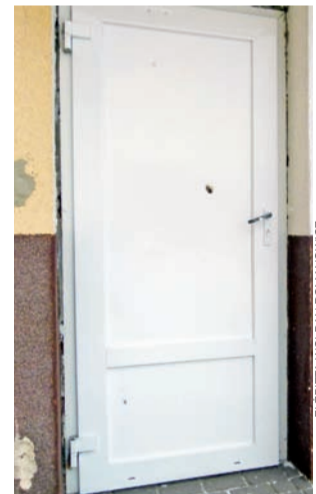
Uszkodzone drzwi. Stan na środę 8 lutego.
