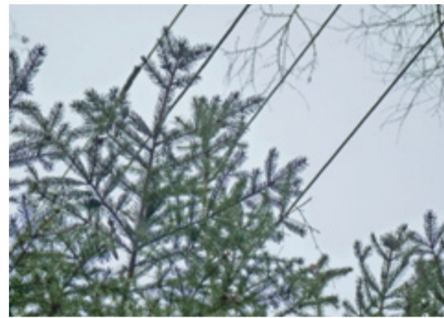
Świerki wrastające w linię energetyczną na jednej z działek w Grodzisku. To m.in. przez nie w Nagawkach dochodzi do przerw w dostawie prądu.
