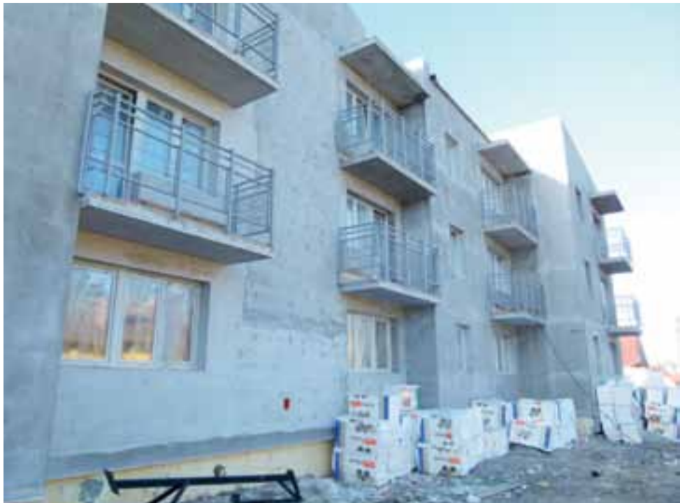
Wykonawcą nowego bloku jest Zakład Remontowo-Budowlany Ella Bronisław Gawrylczuk z Sochaczewa. Gmina podpisała z nim umowę o wartości brutto 2.985.121,036 zł. Nadzór inwestorski w wykonaniu firmy Arkonbud Kucharek Bogumił z Łowicza kosztował będzie gminę 105.042 zł.
