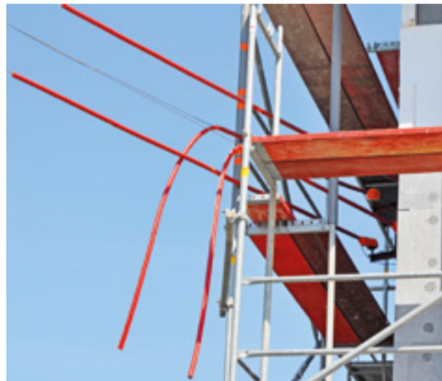
Czy takie zabezpieczenie przewodów pod napięciem było właściwe będzie oceniała prokuratura oraz inspekcja pracy.
