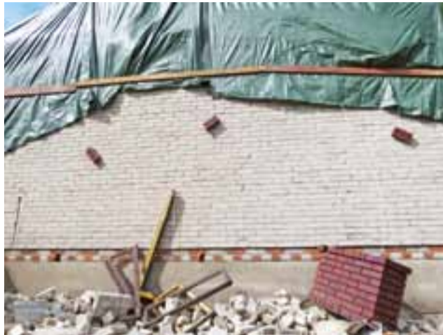
W Szczecinie wiatr porwał dach i zniszczył część szczytowych ścian domu.
