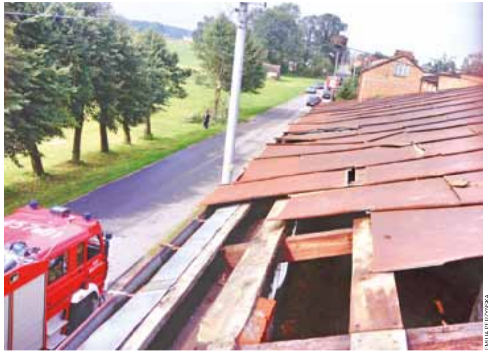
Po wichurze. Tutaj dach został częściowo zupełnie zerwany, a częściowo uszkodzony tak, że wymaga wymiany.
