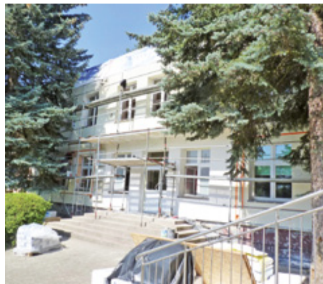
Szkoła Podstawowa w Niesułkowie przechodzi metamorfozę już od kilku lat. Zaczęło się od budowy nowej sali gimnastycznej, teraz budynek nabiera nowego wyglądu dzięki termomodernizacji.
