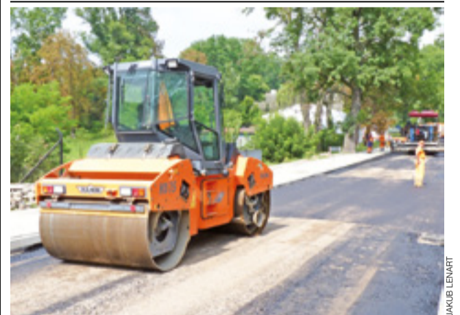
Położeniem nowej nawierzchni zakończyła się prowadzona od lipca przebudowa ul. Dworskiej w Głownie na odcinku od ul. Łowickiej do Wigury. Prace przy tym ostatnim etapie przebudowy rozpoczęły się 17 sierpnia. W ramach inwestycji na Dworskiej pojawiła się nie tylko nowa nawierzchnia, ale także chodniki i zjazdy do posesji. Najważniejszym elementem była jednak przebudowa mostu na Brzuśni. Za wykonanie inwestycji firma Włodan ma otrzymać 617 tys. zł. kl
