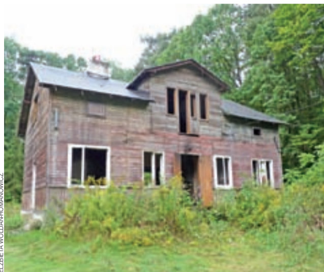
Tu paliły się stropy. Pustostan na Głownej w Głownie.
