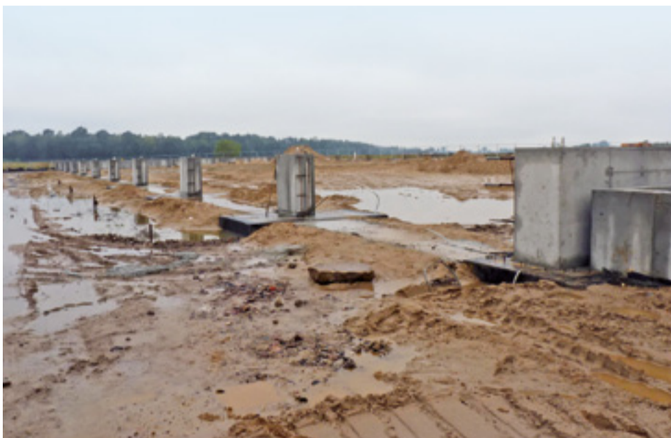
Tu powstać ma hala sortowni RZZOK. Stan na piątek 22 września, po wstrzymaniu prac.
