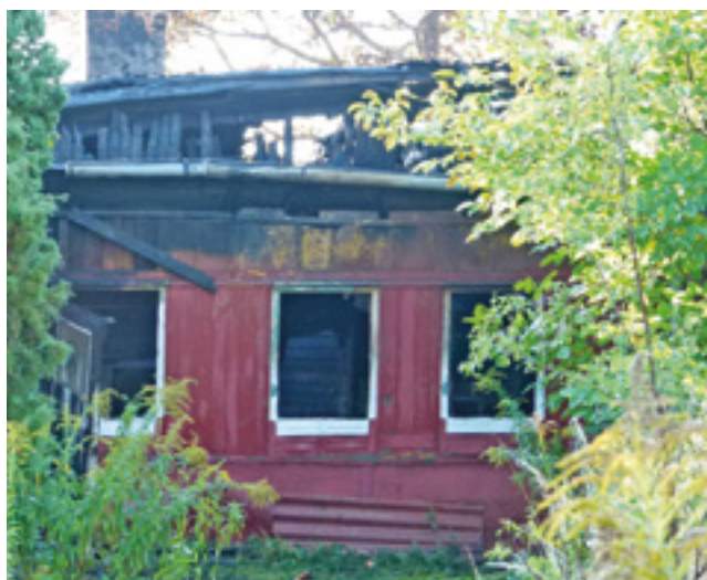
Widok na pustostan od strony ul. Słowackiego odsłoniła dopiero akcja gaszenia pożaru.
