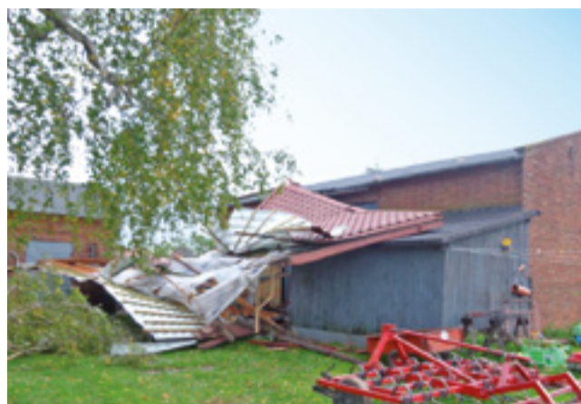
Zerwany przez orkan dach domu w Bratoszewicach upadł na podwórko.
