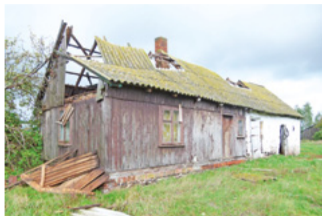
Do rozbiórki. Uszkodzenia w budynku gospodarczym na posesji Mariana Dziegielewskiego w Mąkolicach.
