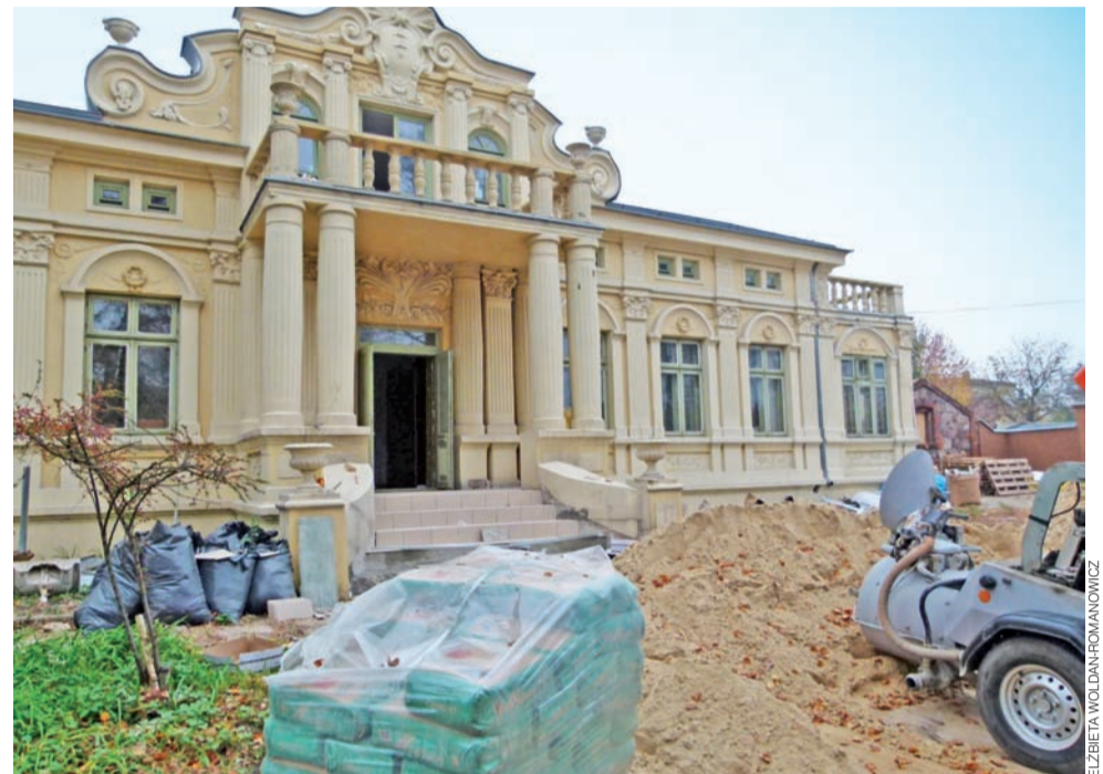
Plac budowy. Pałac Jabłońskich w trakcie adaptacji na potrzeby Środowiskowego Domu Samopomocy, stan na 20 października.
