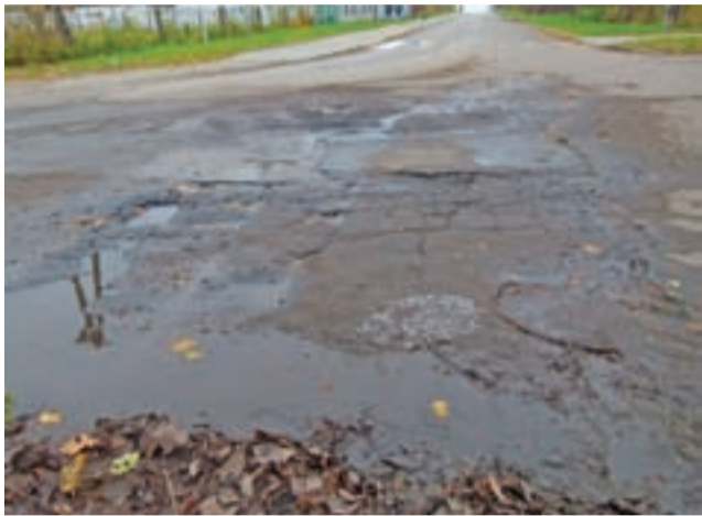
Nadmiar wody , który nie ma gdzie spłynąć, zbiera się na nawierzchni placu Reymonta.
