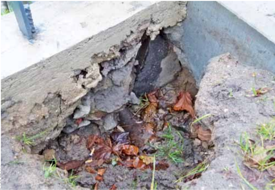
Tuż przy konstrukcji mostu pojawiła się duża wyrwa w ziemi.
